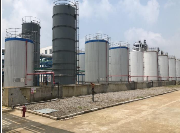
厂区储罐区设置了围堰
