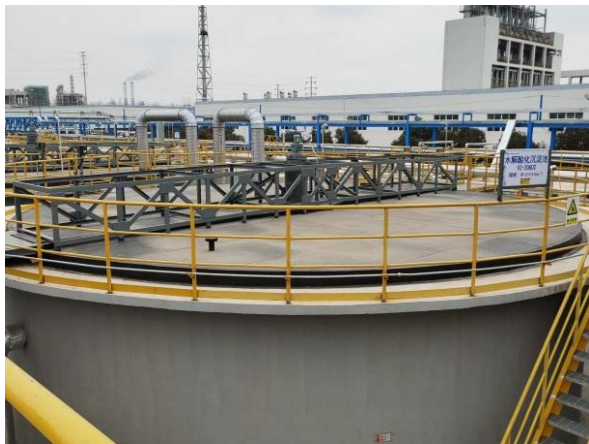
水解酸化沉淀池
