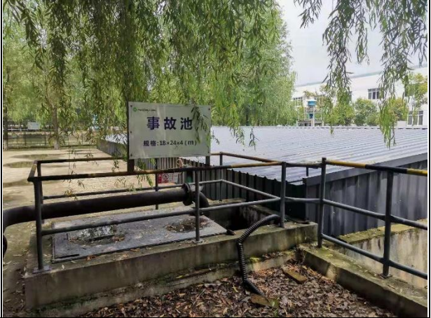
厂区事故应急池
